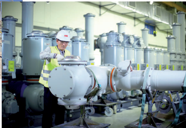
Gasisolierte Schaltanlage in Katar. Foto: Nic Arnold Photography / ABB
