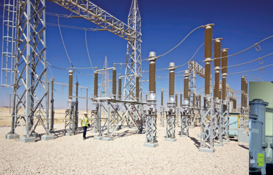
Umspannwerke transformieren die elektrische Energie von einem Spannungswert in einen anderen. Oft sind sie luftisoliert, so wie dieses Umspannwerk im Oman. Steht hingegen nur wenig Platz zur Verfügung, sind sie meist gasisoliert. Foto: Nic Arnold Photography / ABB
