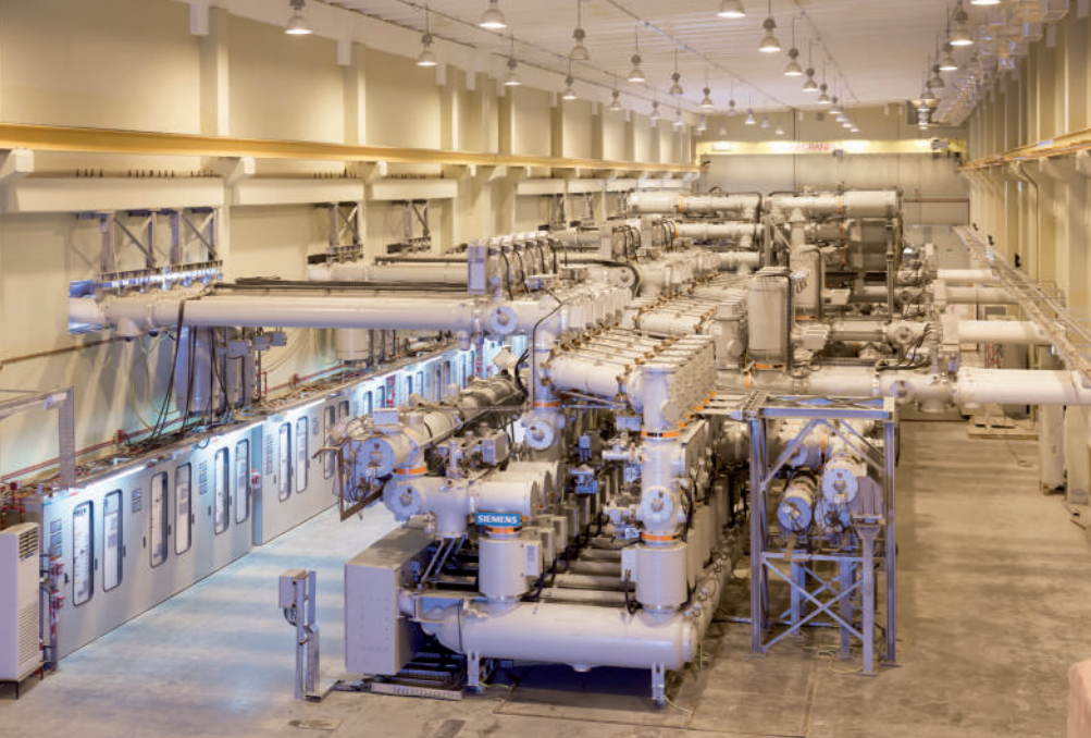
Das Umspannwerk Daxlanden bei Karlsruhe bekommt neue Schaltanlagen. Statt mit SF 6 sind sie mit aufbereiteter komprimierter Luft isoliert. Foto: Siemens
